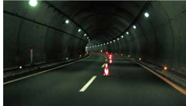
【従来(蛍光灯照明)】 路面の明るさが均一でない。縞がある。
