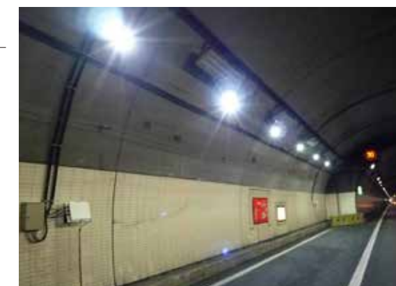
NECOL-T(EPA) 通常運用4,000lm 高知道 平山トンネル(上り線)
